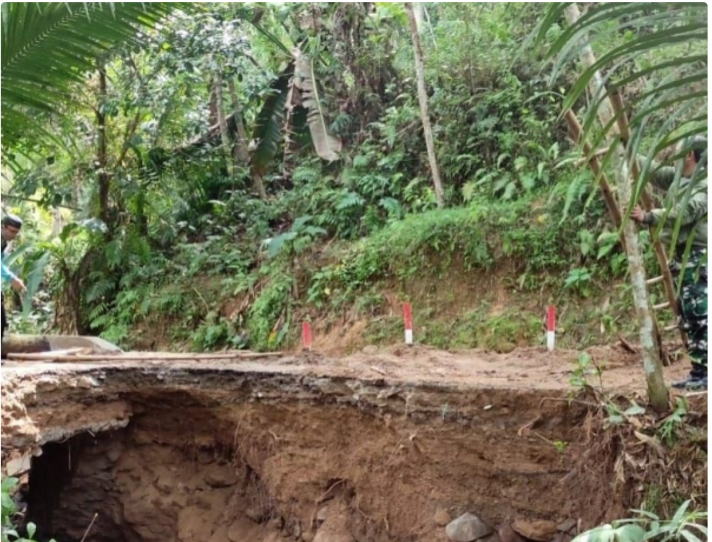
Danramil 22/Ayah Kodim 0709/Kebumen Minta Warga Segera Perbaiki Kerusakan Jembatan
